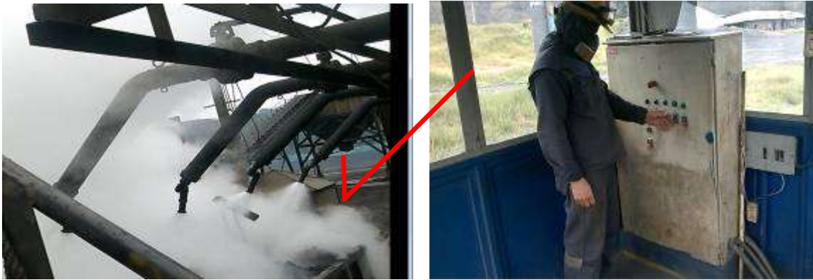
Figura N. 26 Operación correcta apagado por medio de sistema eléctrico
