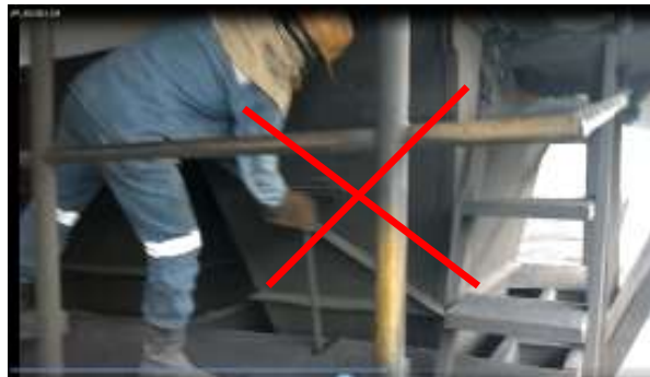
Figura N. 15 Postura incorrecta operación cargue de horno con materia prima
