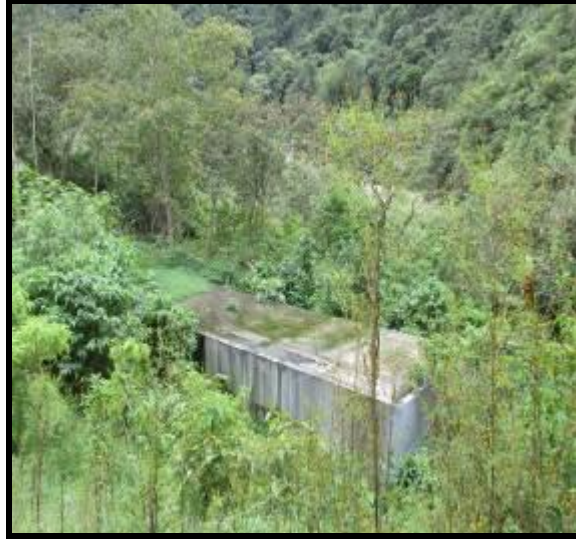
Figura 4. Tanque de tratamiento colmatado de lodos Fuente: Unidad de servicios públicos
