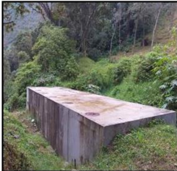
Figura 9. Tanque de tratamiento PTAR Fuente: Unidad de servicios públicos
