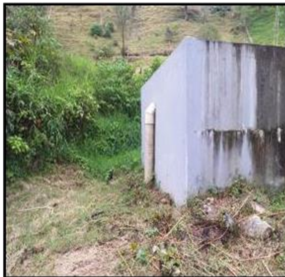
Figura 11. Conducción de salida PTAR
