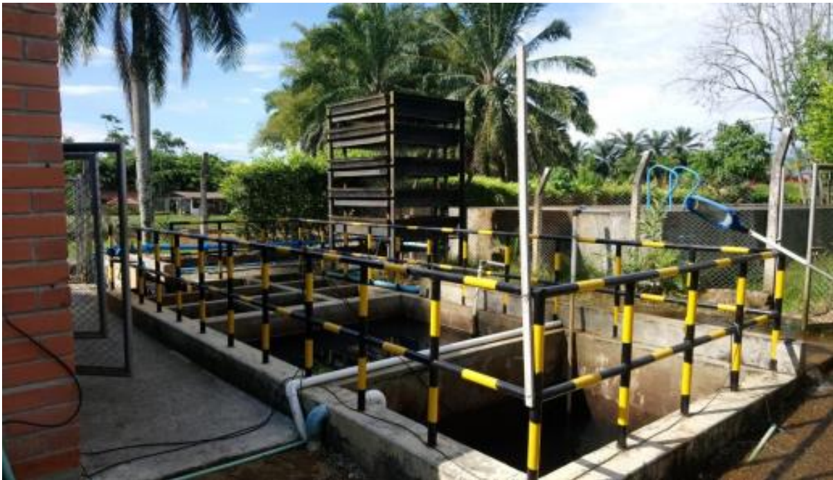
Figura 4. Planta de tratamiento de agua potable
