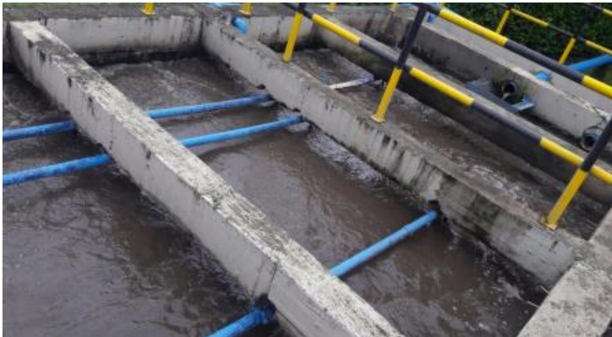
Figura 5. Planta de tratamiento de agua residual.
