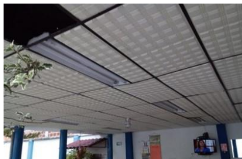
Figura 5. Tubos halógenos de 36 W marca Philips
