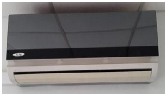
Figura 31. Aire acondicionado marca KOLER
