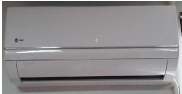
Figura 30. Aire acondicionado marca TRANE
