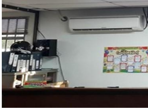
Figura 27. Aire acondicionado marca Samsung
