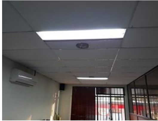
Figura 22. Plafones tubos con tecnología LED de 18 W
