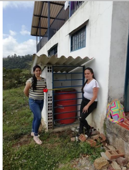
Imagen 36. Medidas del sitio de almacenamiento de residuos peligrosos.
