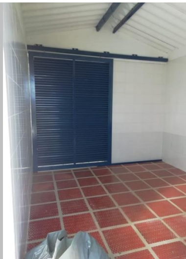
Imagen 20. Almacenamiento de residuos inorgánicos.
