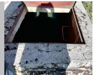
Imagen 23. Tanque de almacenamiento de agua enterrado.
