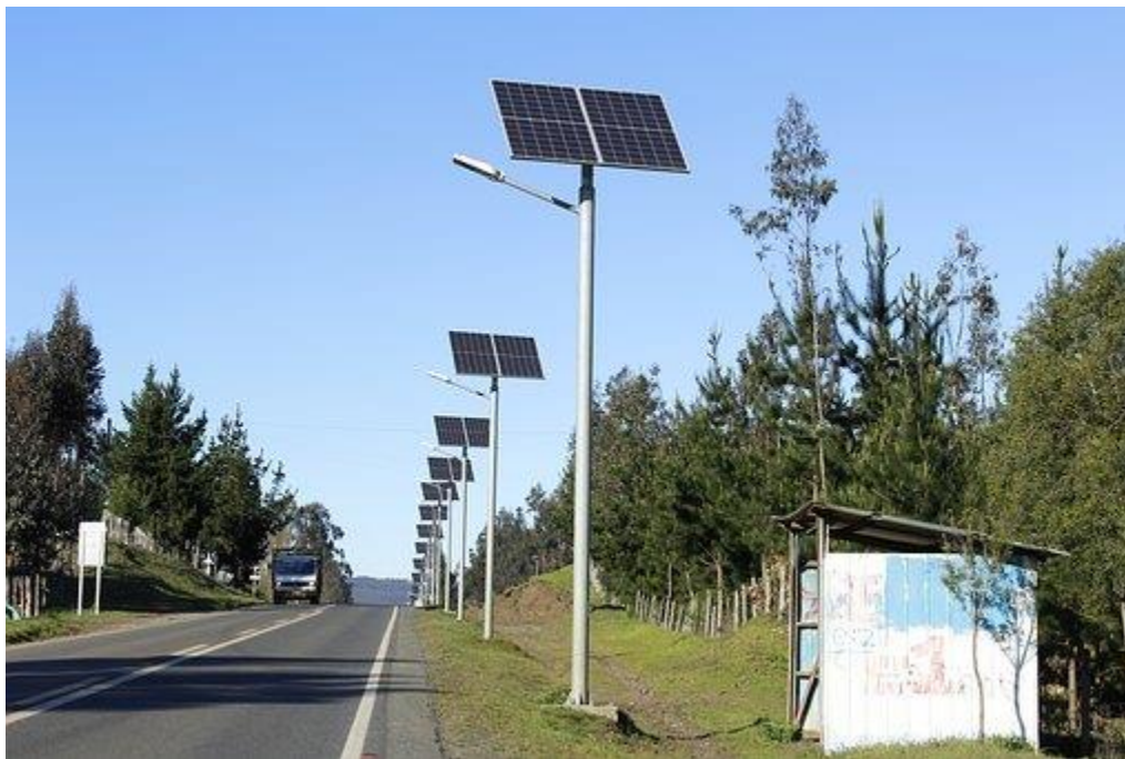
Ilustración 11: Alumbrado público fotovoltaico.
