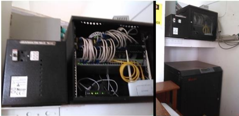
Figura 42. Cuarto de comunicaciones.
