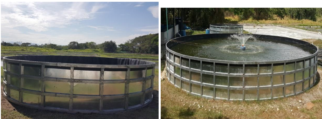
Figura 7. Tanques en geomembrana.
