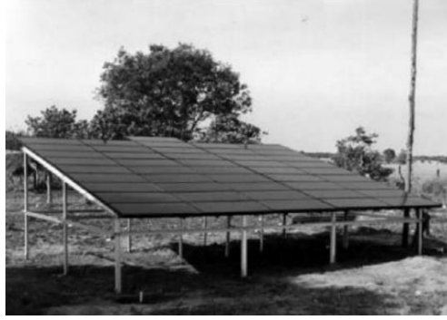
Imagen 1. Sistema solar instalado. Fuente: Instituto Colombiano de energía eléctrica
