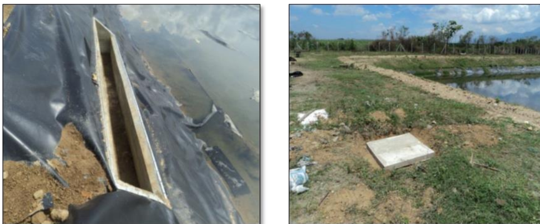
Ilustración 8 Cámaras de recolección e inspección
