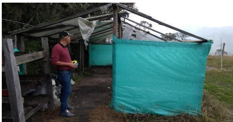
Fotografía 2. Estructura que anteriormente se utilizó como vivero, pero ahora está abandonado y con daños considerables. La estructura ha perdido la cubierta y la madera está deteriorada. Junio 1 de 2019
