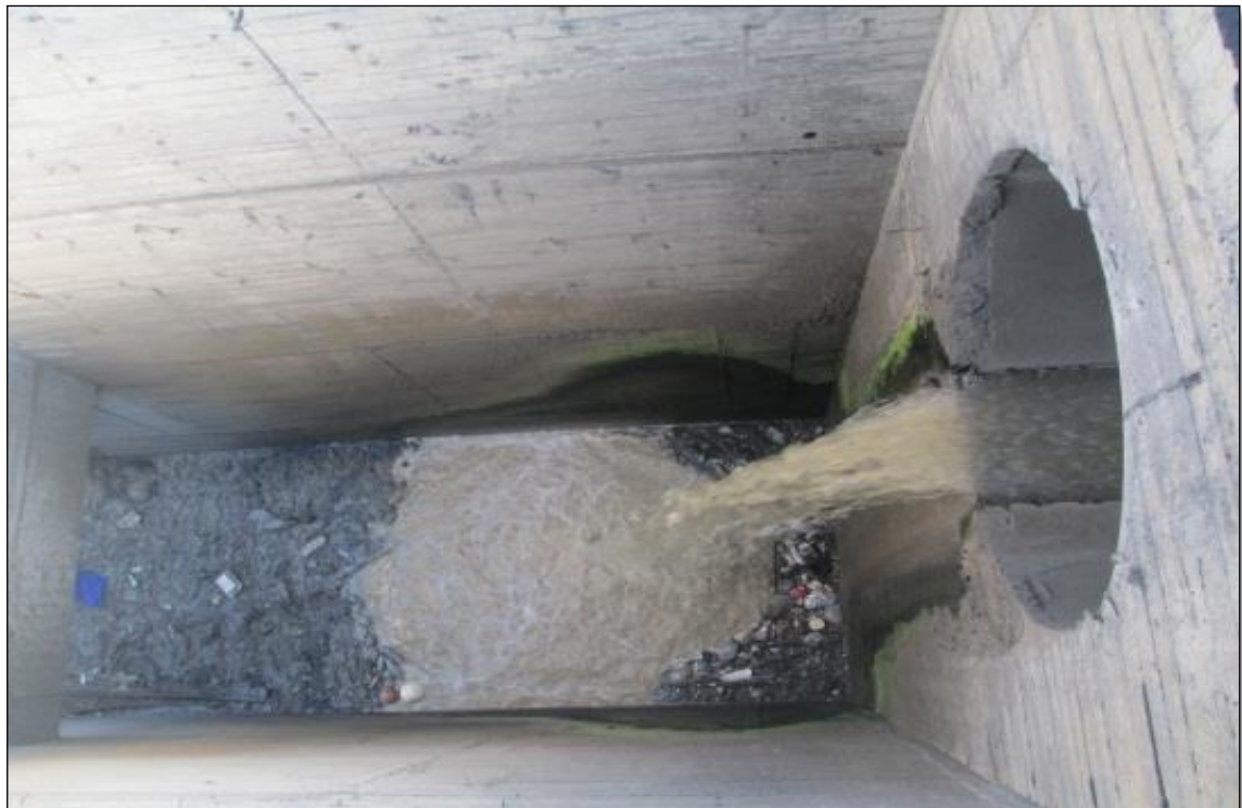
Figura 17. Estructura de Vertimiento Caney – Aguas Arriba.
