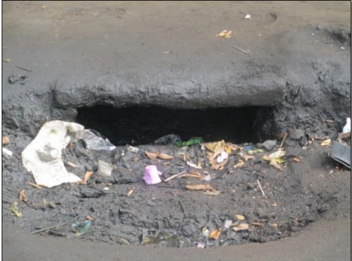
Figura 26. Sumideros Afectados por Residuos Sólidos, Grasas y Aceites.
