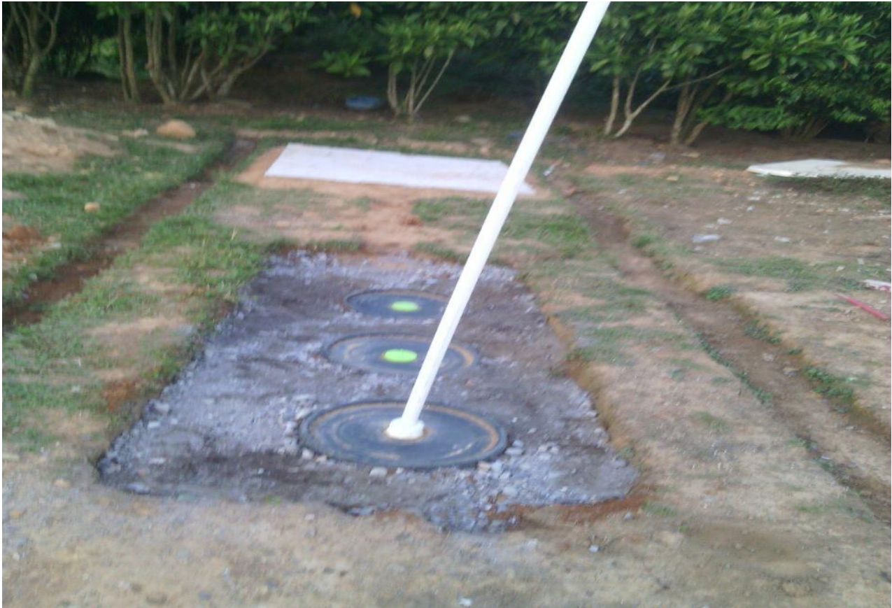
Figura 13: SISTEMA DE FOSA INSTALADO Y FUNCIONANDO.
