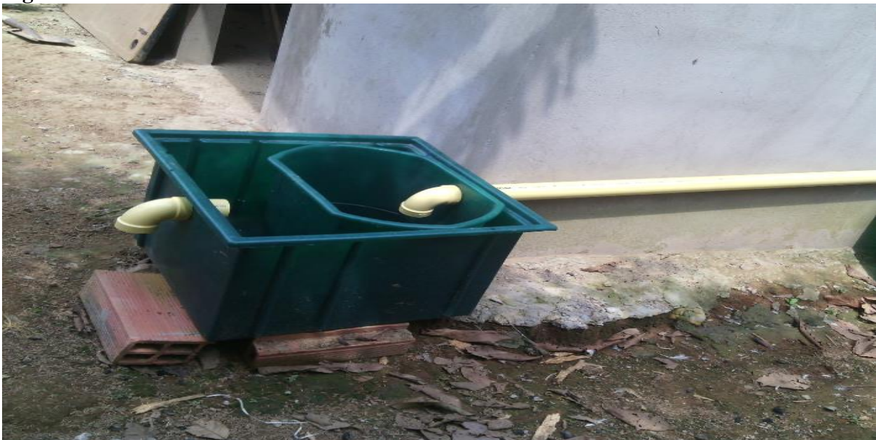
Figura 14: TRAMPA DE GRASA INSTALADA.
