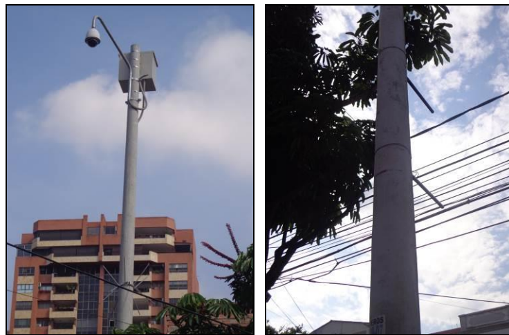
Figura 40. Punto No. 1. Avenida 9 Norte con 12N.
