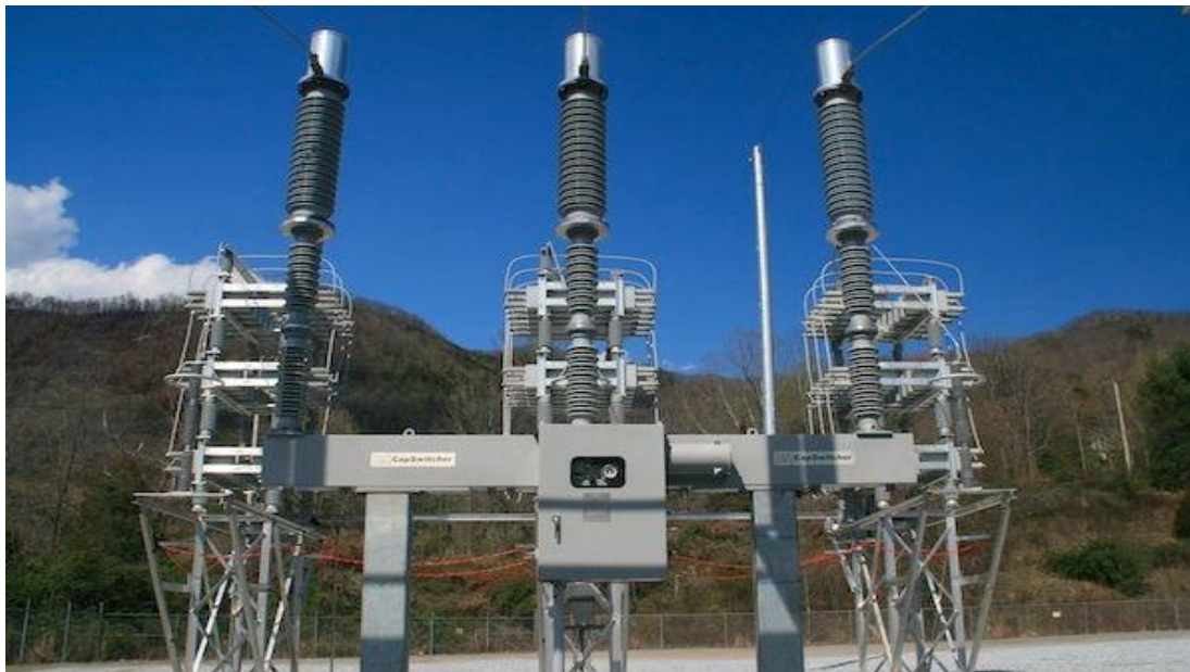
Figura 3. Interruptores o disyuntores eléctricos
