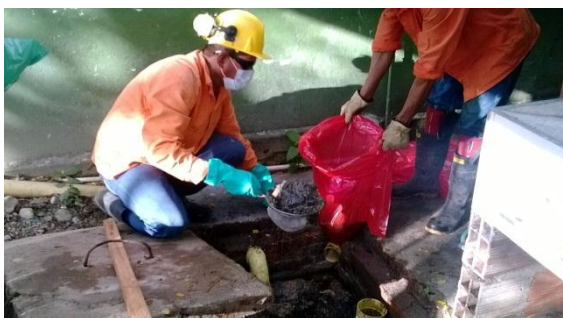
Imagen 4. Limpieza de la trampa grasa.
