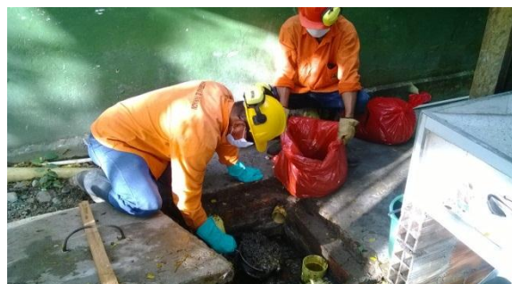
Imagen 5. Limpieza de la trampa grasa.
