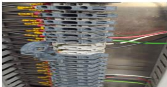
Conexión sensor en el PLC
