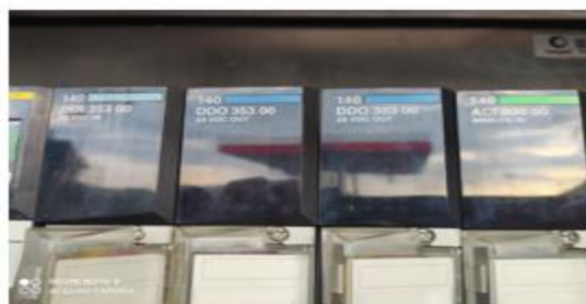
Ingreso de señal al PLC
