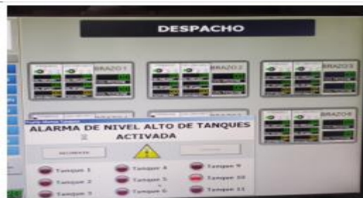
Alarma en el HMI
