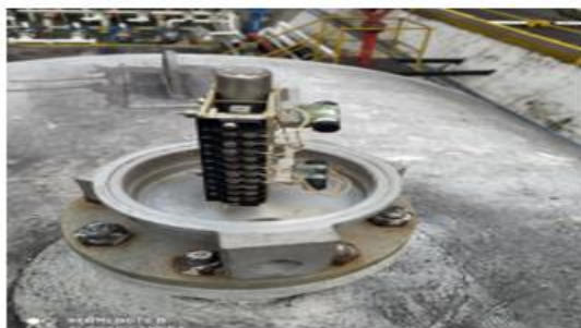
Instalación sensor en el tanque
