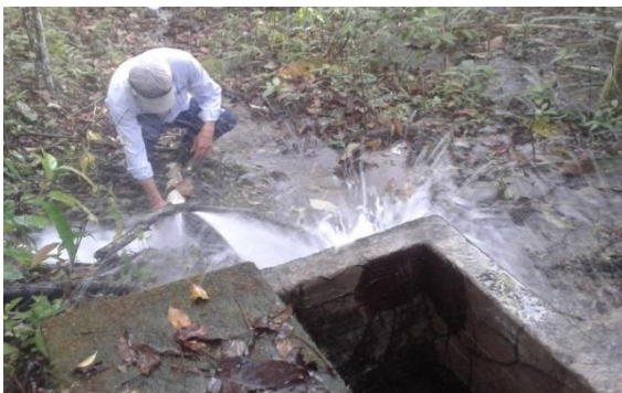
Figura 25. Ventosa con fuga considerable. Fuente: Autor
