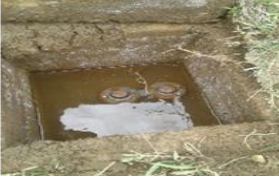
Figura 26 Ventosa con fuga considerable. Fuente: Autor
