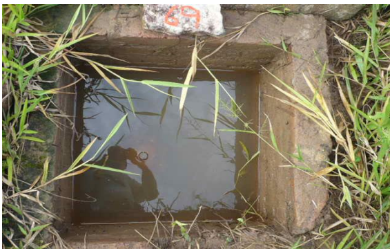
Figura 23 Válvula donde se realizó el aforo. Fuente: Autor
