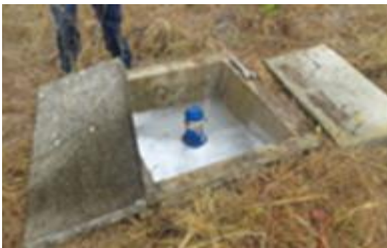
Figura 24. Ventosa con fuga considerable. Fuente: Autor
