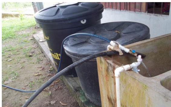
Figura 34 Acometida sin medición. Fuente: Autor
