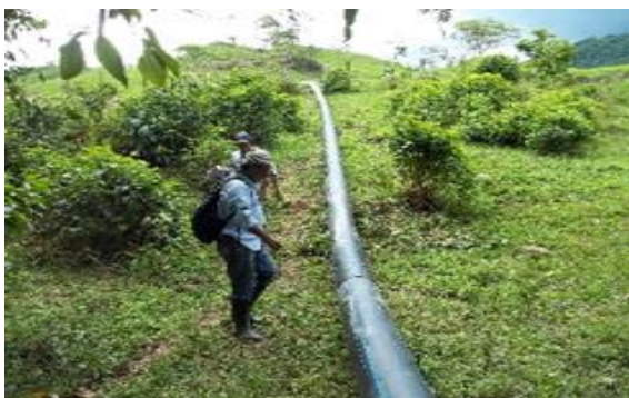
Figura 8 Tubería de polietileno nueva. Fuente: Autor
