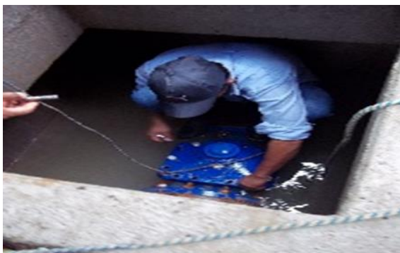
Figura 17. Macro medidor de 12" aforo volumétrico. Fuente: Autor
