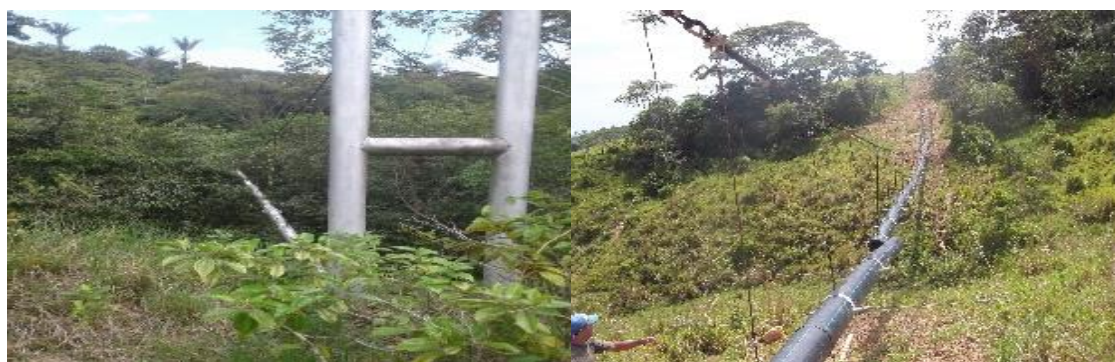
Figura 28. Tubería de polietileno. Fuente: Autor
