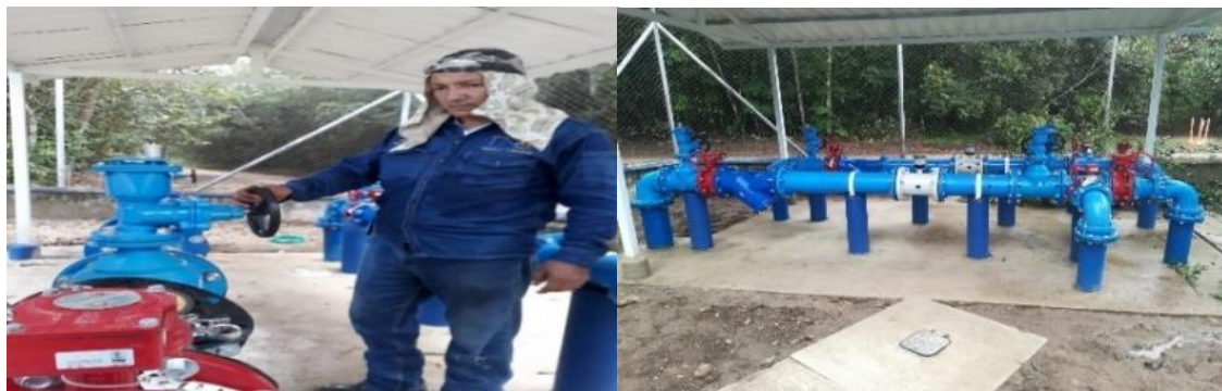
Figura 35. Estación macro medidora PTAP. Fuente: Autor
