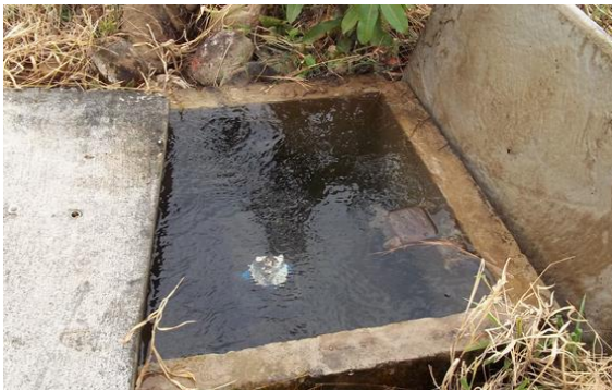
Figura 11. Caja – Válvulas de purga. Fuente: Autor
