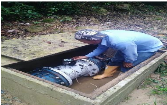
Figura 18. Nuevo macro medidor tipo magnético. Fuente propia
