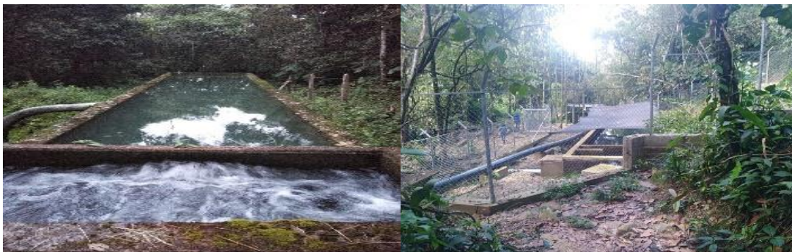
Figura 7 Estructuras de desarenación. Fuente: Autor
