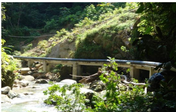
Figura 4. Tramo línea aducción. Fuente: Autor
