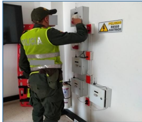
Figura 17. Activación del Sistema FSE - Frentes de Seguridad Electrónica
