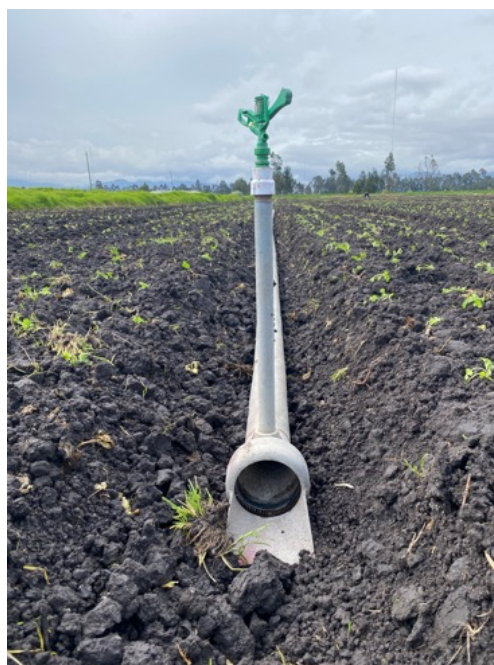
Control de humedad (manual-aspersor)
