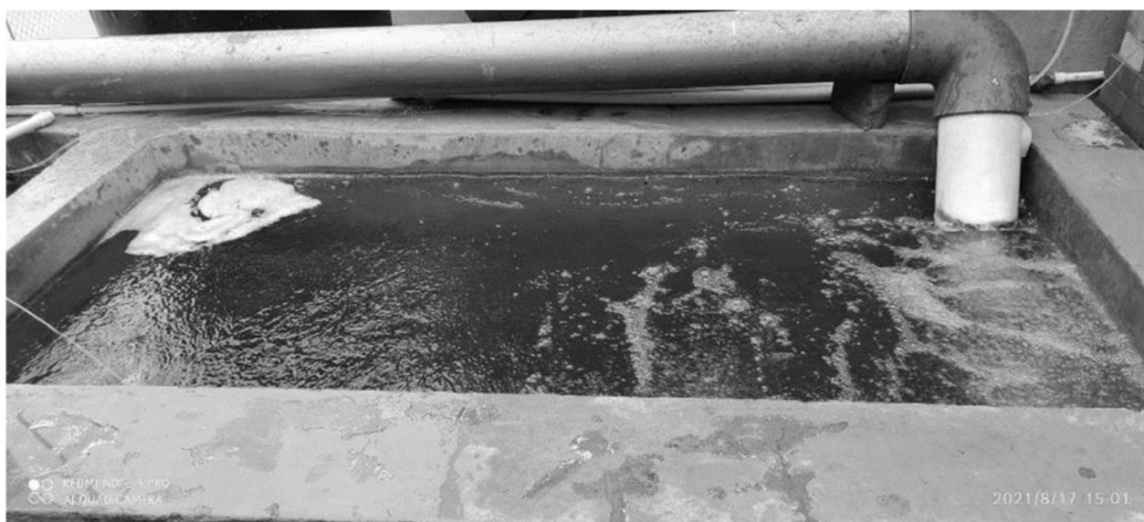
Tanque de quietamiento
