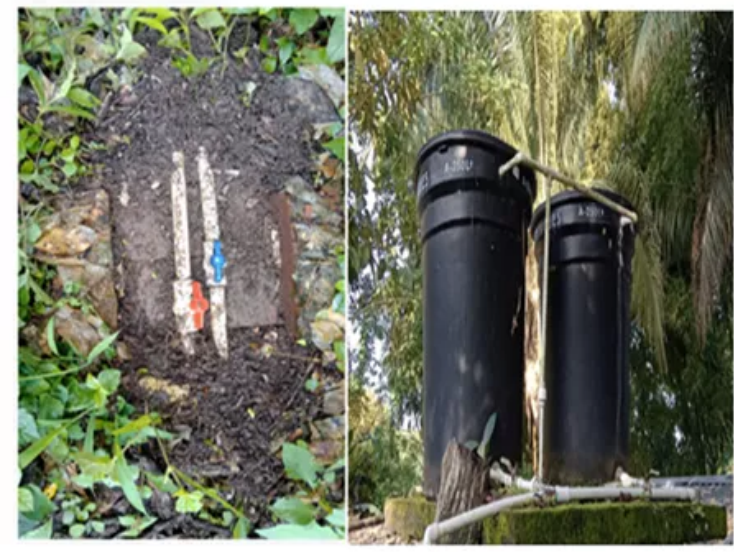
Figura 8. Acueducto Veredal y tanques de almacenamiento
