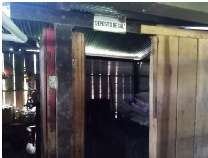
Figura 9. Lugar inadecuado para los alimentos.
