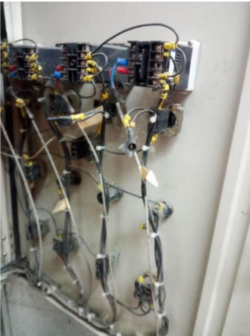
Puerta Cofre Conexiones Internas
