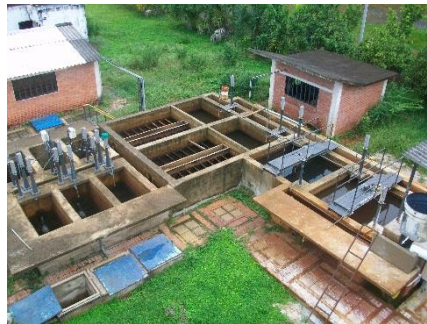
Figura 3. Panorámica de la PTAP. Fuente: autor
