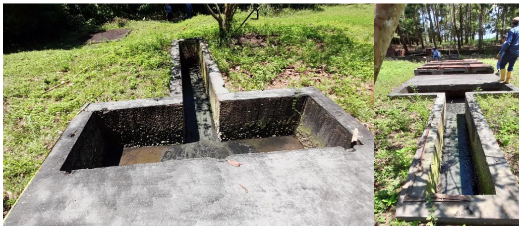
Figura 5. Caja de salida PTAR
