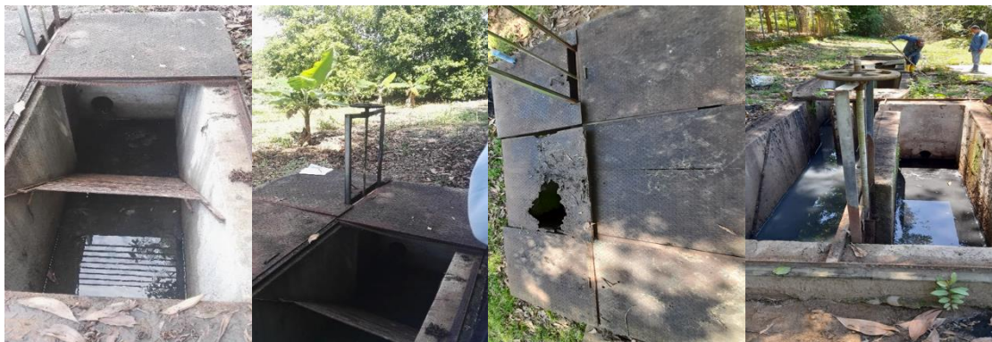
Figura 3. Canal de entrada a la PTAR
