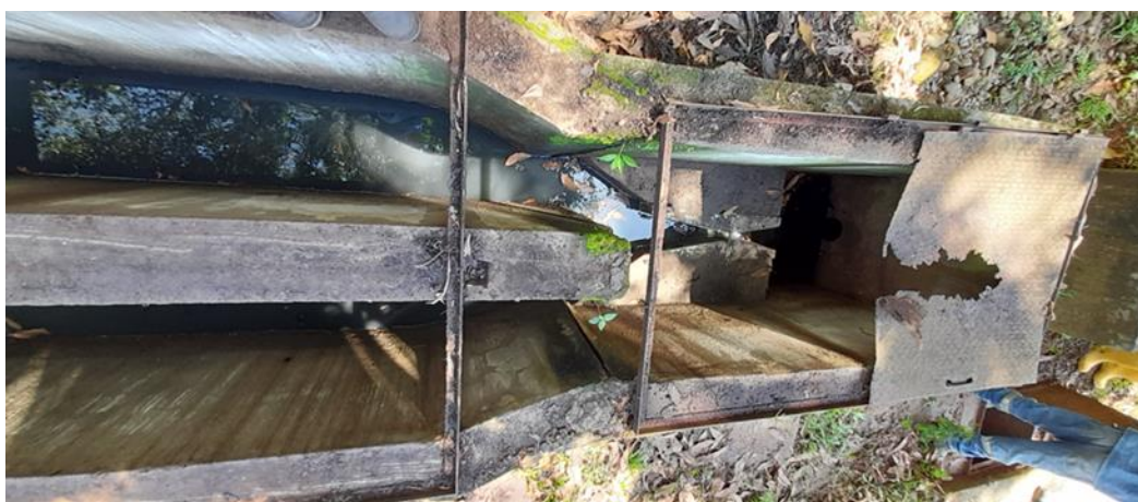
Figura 7. Canaleta Parshall PTAR El Toro
