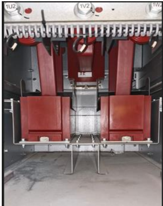
Imagen de los transformadores de corriente
