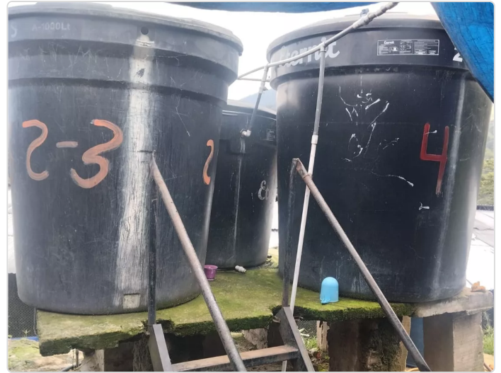
Figura 5. Tanques para el suministro de agua
