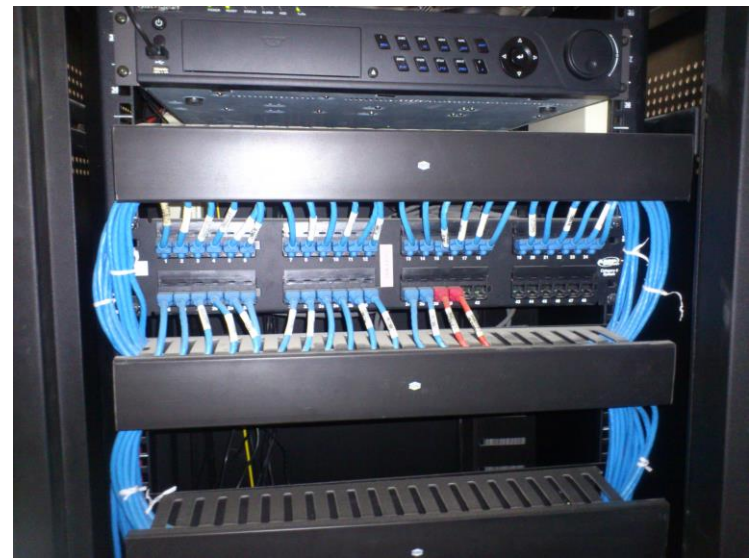
Rack principal de comunicaciones
