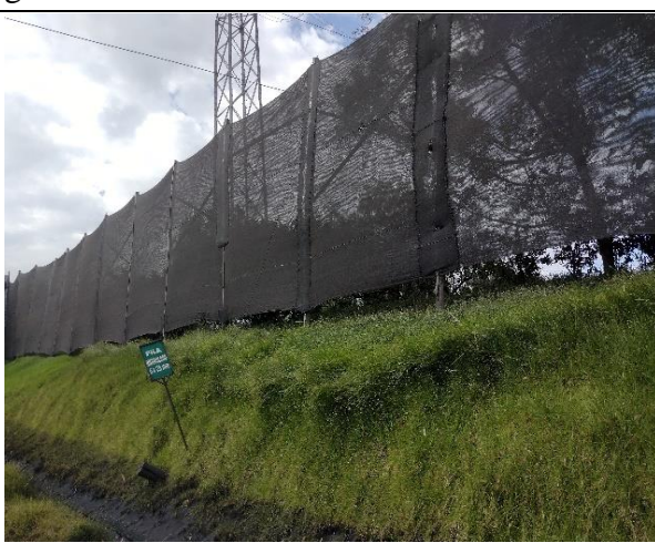
Estado de la polisombra al 80% de zona la perimetral del centro de acopio
