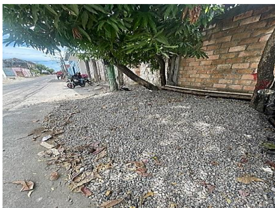
Materiales de cantera para mejoramiento del suelo acopiado en lugar inadecuado.
