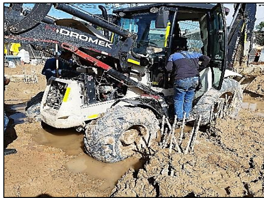
Cambio de aceites y reparacion de la maquinaria en una area inadecuada en la obra.
