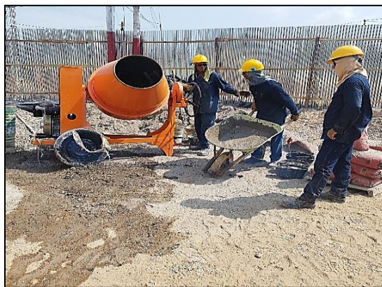
Mezclado de concreto en area inadecuada teneidno en cuenta que se esta directamente en un sitio que no cuenta con un solado en concreto pobre, no se cubrió el suelo donde se manejo la mezcla, con una cobertura de polietileno.
