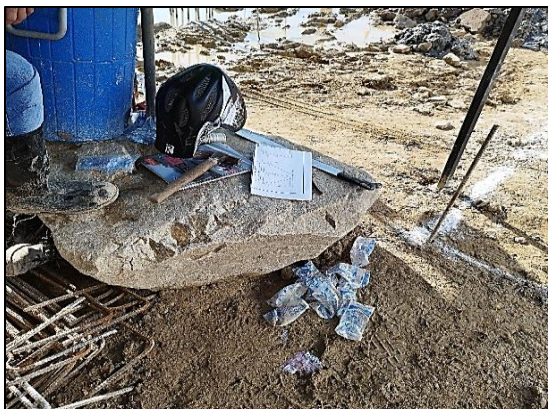
Mala disposicion de material plastico por parte de los trabajadores a la hora de hidratarse.
