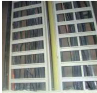
Figura 9. Distribución de cables en la infraestructura
