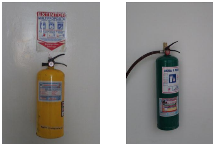
Figura 17. Elementos de seguridad contra incendios
