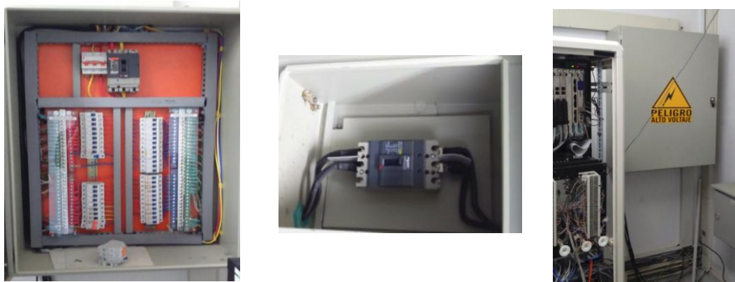
Figura 7. Tablero de control eléctrico área de servidores
