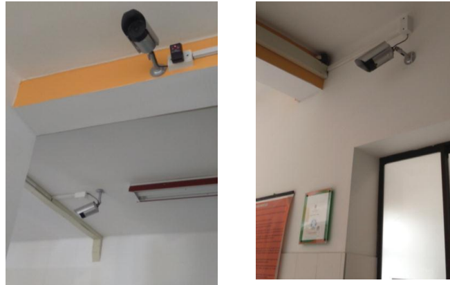
Figura 15. Cámaras de vigilancia área asistencial.
