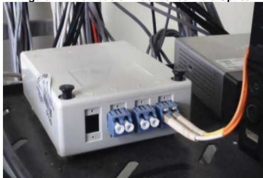
Figura 11. Distribución Backbones Fibra Óptica
