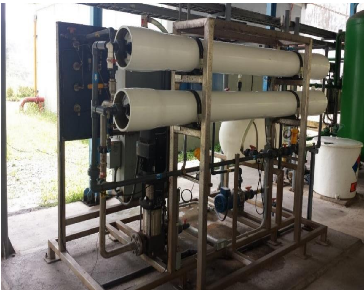
Figura 4. Ósmosis inversa, Cementos Argos planta RíoClaro. Fuente: Autores.
