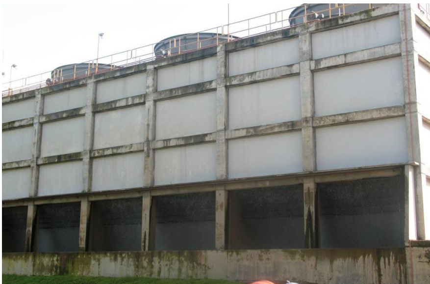
Figura 1. Torre de enfriamiento, Cementos Argos - planta RíoClaro. Fuente: Autores.
