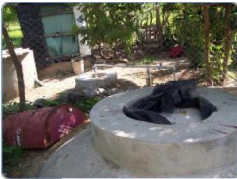
Biodigestor de Domo Fijo
