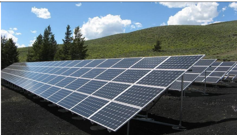
Figura 18: Un conjunto de paneles solares, una fuente verde de energía de CC
