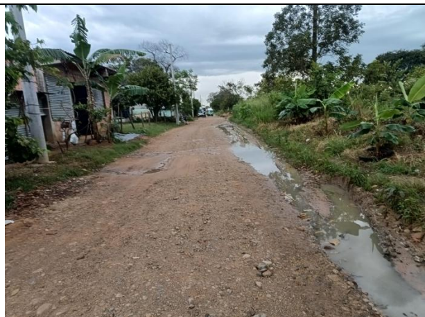
Fotografía 6. Vía con flujo de aguas servidas.
