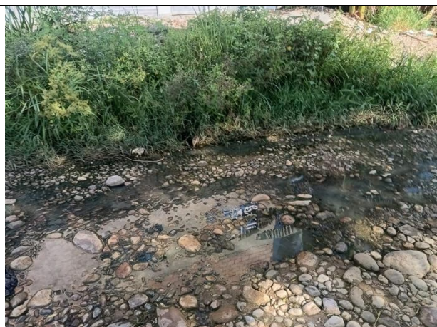
Fotografía 8. Vía interna del barrio con flujo de aguas servidas.
