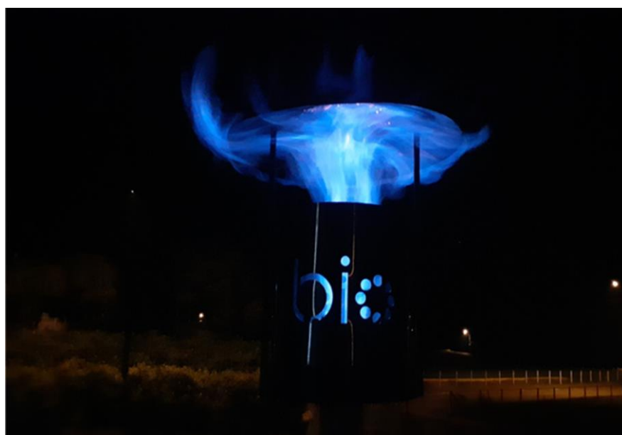
Sistema de Evacuación de Gases
