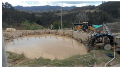
Imagen 7. Zona de decantación de lodos
