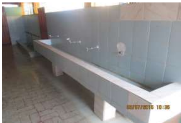
Area de baños (Dispositivos poco apropiados)
