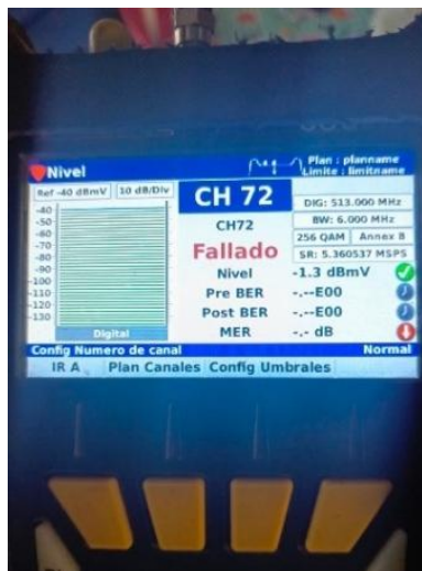
Figura 8 Estado inicial del sistema con falla de recepción.
