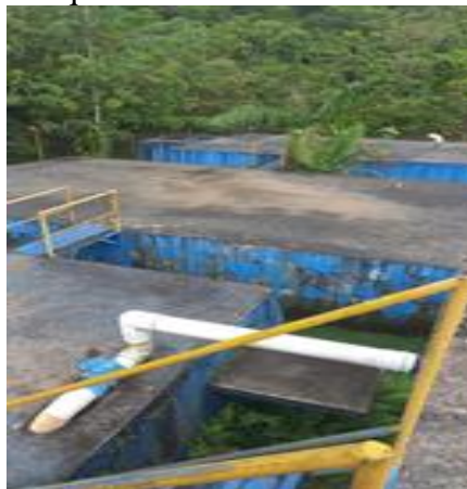
Imagen 13 Tanque de contacto de cloro
