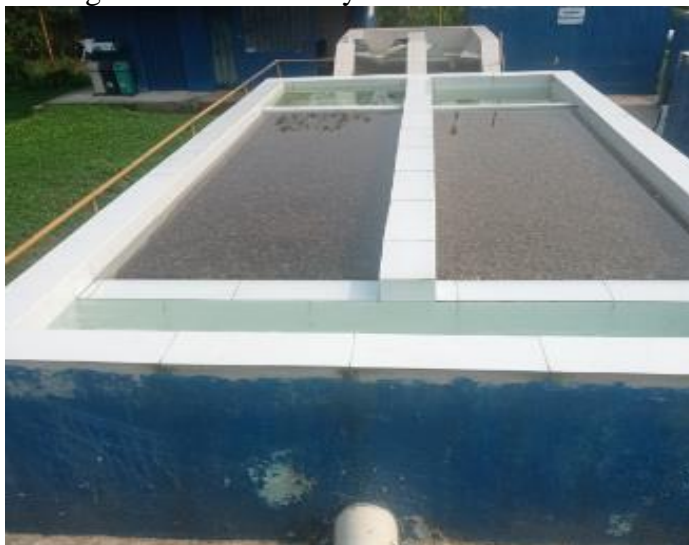
Figura 12. Filtro grueso descendente y ascendentes
