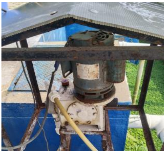
Figura 15. Bomba dosificadora de cloro
