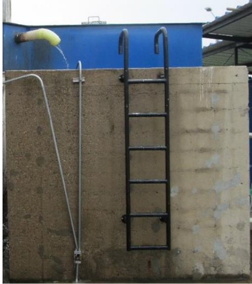
9. Tanque de almacenamiento para filtración
