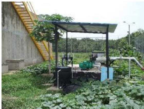
11. Tanque de almacenamiento para cloración
