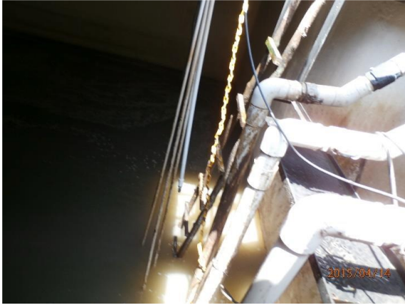
5. Tanque de igualación
