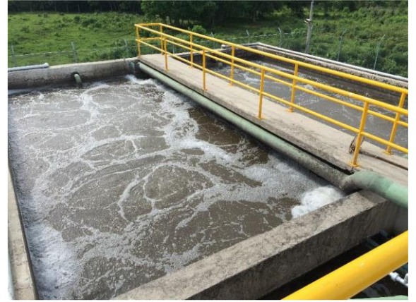
6. Reactores biológicos de lodos activados
