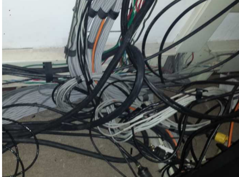
Figura 9. Disposición de cables
