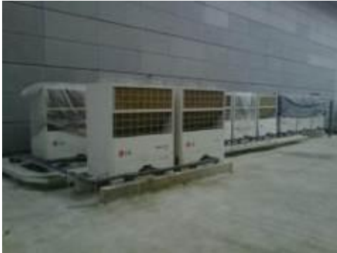
Figura 6. Sistemas de aire acondicionado.
