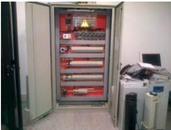
Figura 8. Tablero de Control
