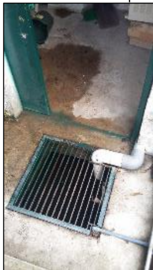
b) Rejilla de mantenimiento en la entrada de la caseta de control 1.
