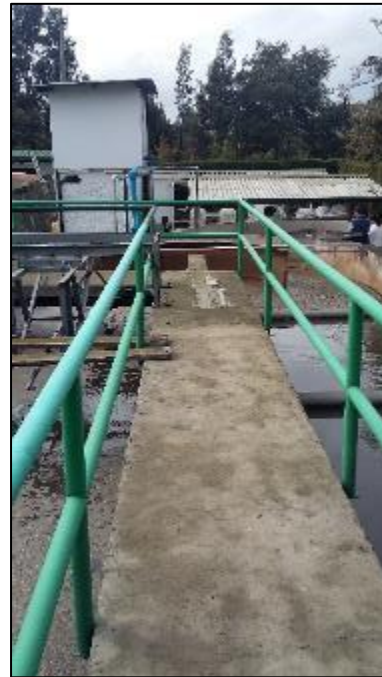
c) Plataforma de operación y mantenimiento de la unidad
