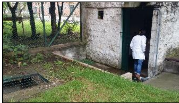
a) Caseta de control 1: operación de bombas luego del ingreso del agua a la PTARD.
