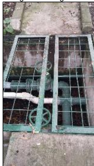
c) Pozo de bombeo: homogeniza y airea el agua.
