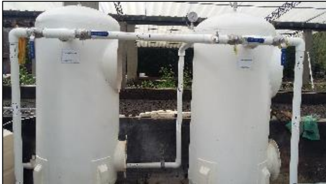
a) Filtros de arena en paralelo.
