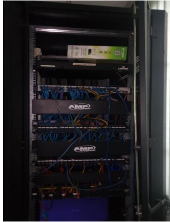
Figura 43. Rack de comunicaciones
