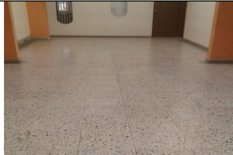
Pisos sin baldosas podo Tactiles
