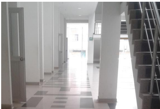
escaleras con pasamanos Pisos no apropiados para discapacitados
