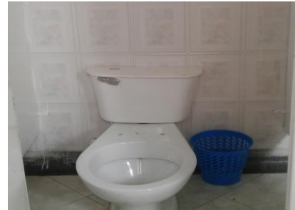
Baño no adecuados para personas en sillas de ruedas
