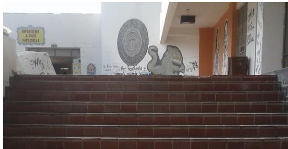
Escaleras sin pasamanos
