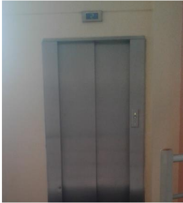
Ascensor para el acceso a los pisos del edificio administrativo
