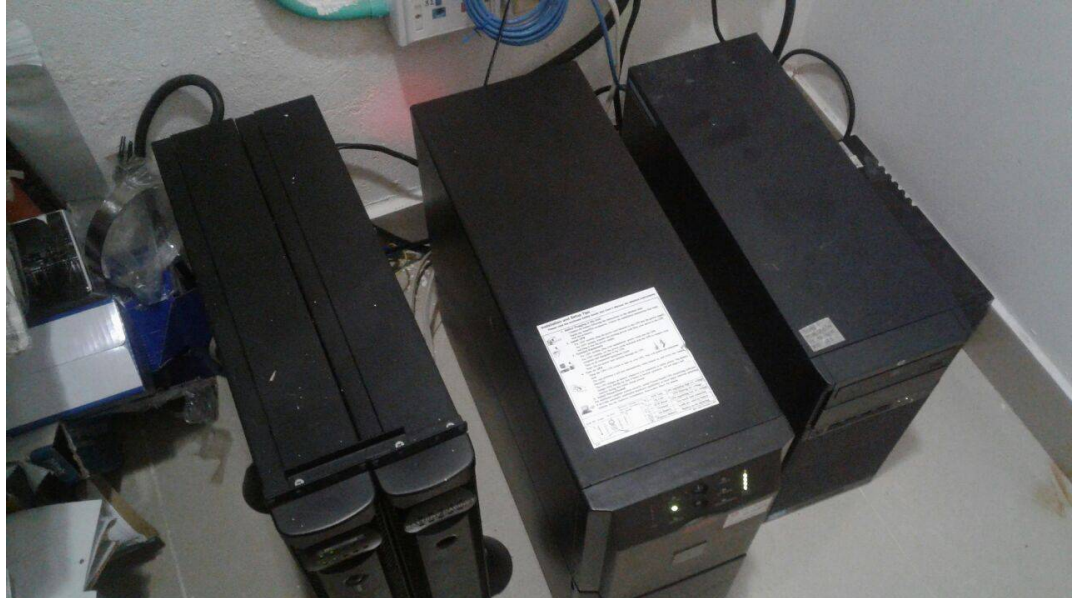
Fuente: Registro fotográfico tomado de Cuarto de Comunicaciones
