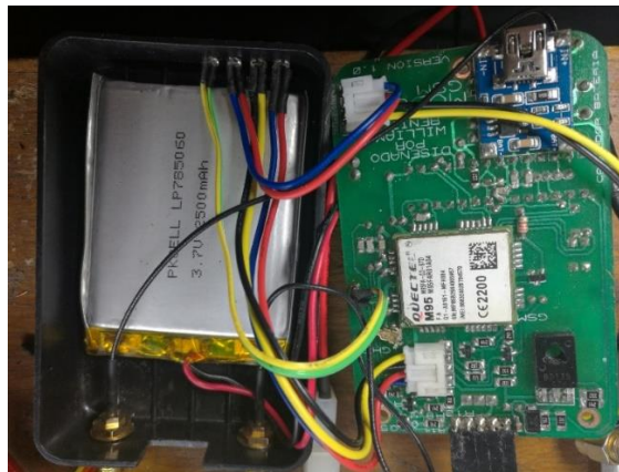
Figura 74 Batería de respaldo incorporada a la alarma
