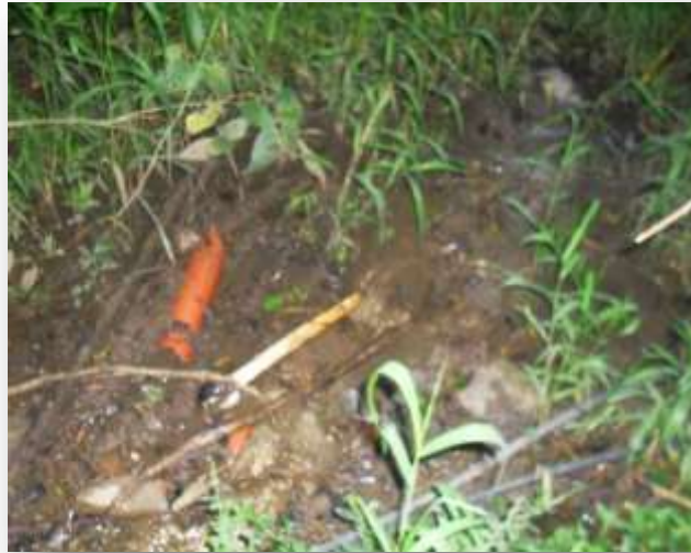
Foto 10. Instalaciones ilícitas para el aprovechamiento de agua por parte de servidumbres.
